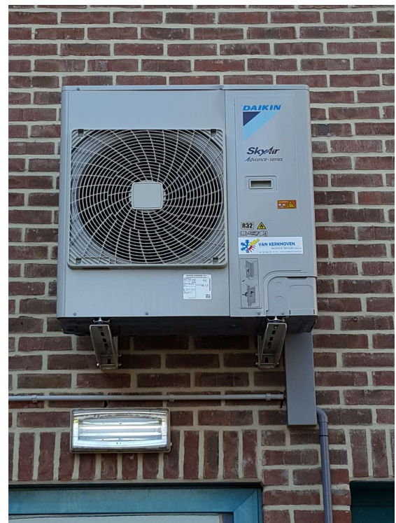
Geplaatste airco SK Leeuw (buitenkant).
