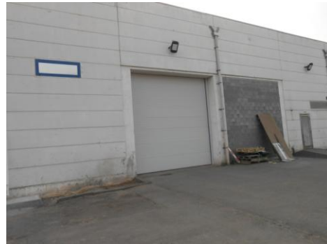
Buitenverlichting + automatische poort
