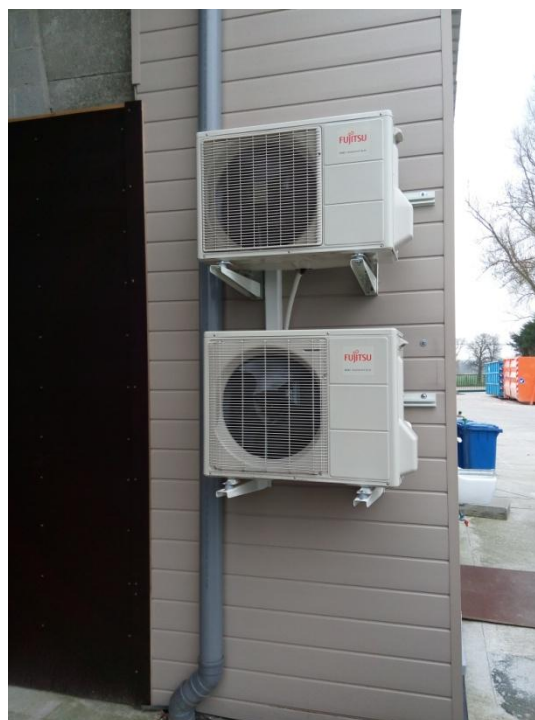
Foto 7: Verwarming- en koelingsinstallatie
