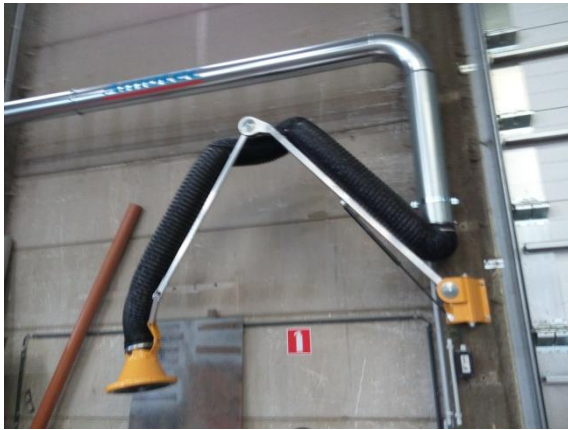
Foto 8: Stof- en gasafzuigingsinstallatie
