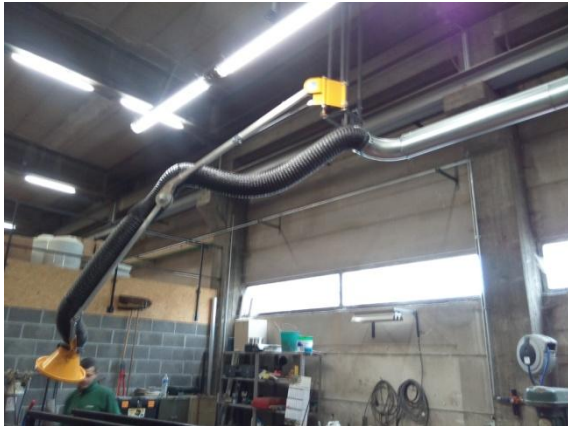
Foto 9: Stof- en gasafzuigingsinstallatie
